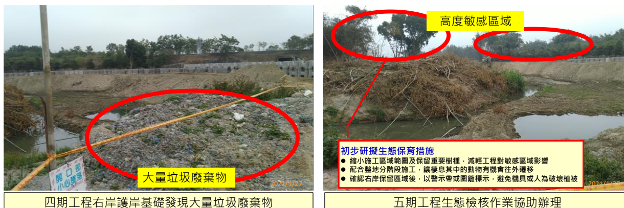
圖 4-2 林子舊社堤防防災減災工程施工中生態檢核狀況說明圖
