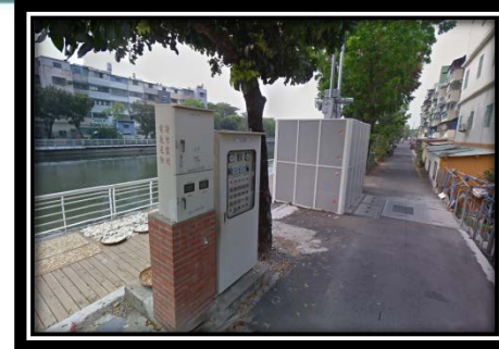
鎮東一街抽水站現況圖
