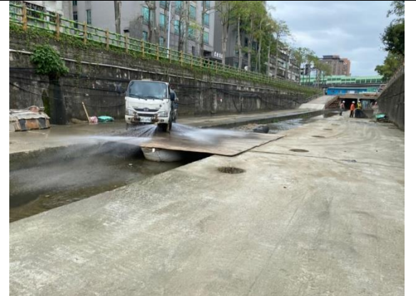
遵照生態團隊建議施工前後灑水，減少揚塵，減少對周遭鳥類、居民影響。
