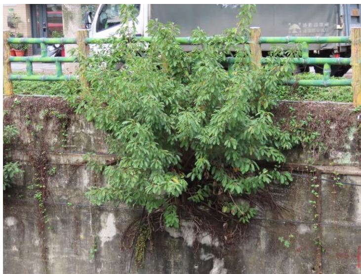
圖為生長於渠道內牆上的雀榕，長大後根部易造成結構危害。
