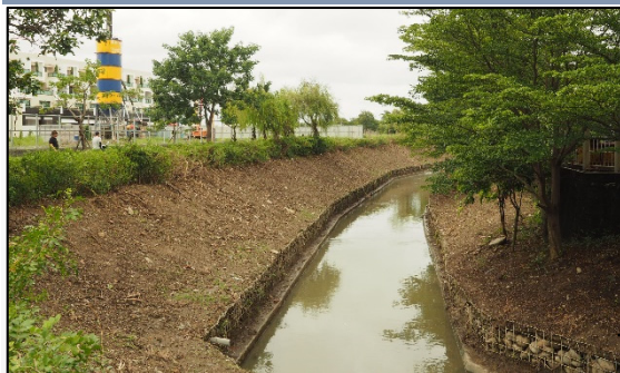
① 九番埤排水護岸土方流失
