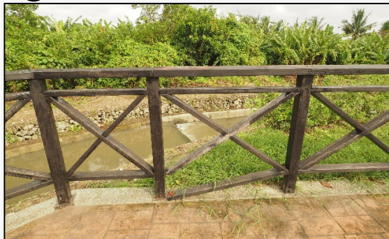
② 護欄破損 民眾使用有安全疑慮
