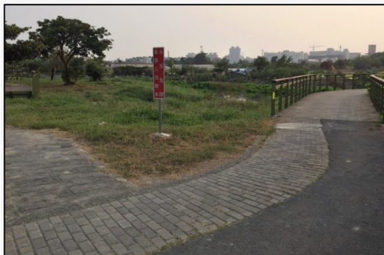
③ 現況欄杆老舊損壞或未連續，影響步行民眾安全性
