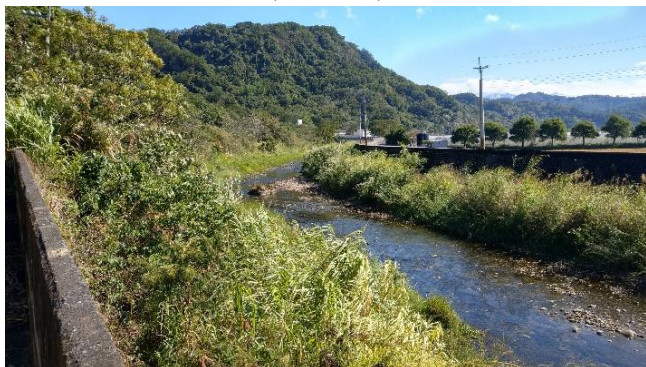
(坡腳受侵蝕段)
