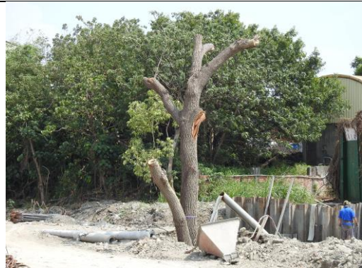
保全對象(#12 樟樹)移植工法過於粗糙
