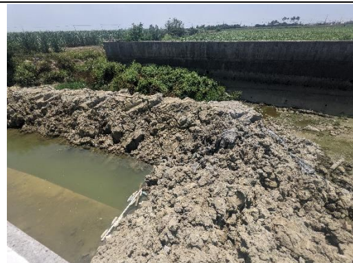
因工程而設置之擋水設施 (拍攝日期 111.04.22)
