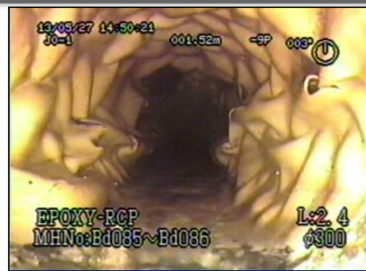
防蝕材料脫落
