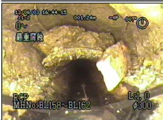
管壁破損塌陷
