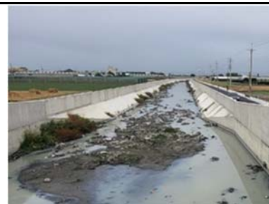
照片 2-6 棲地 2【完工後】 日期：112 年 12 月 04 日 位置：四番地橋上游 概況：水流少而平緩
