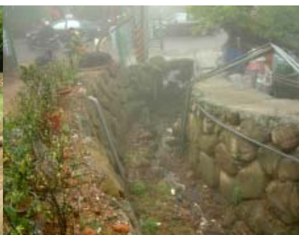
圖 2-19 竹子湖溪穿越崩塌區下方餐廳處現況。
