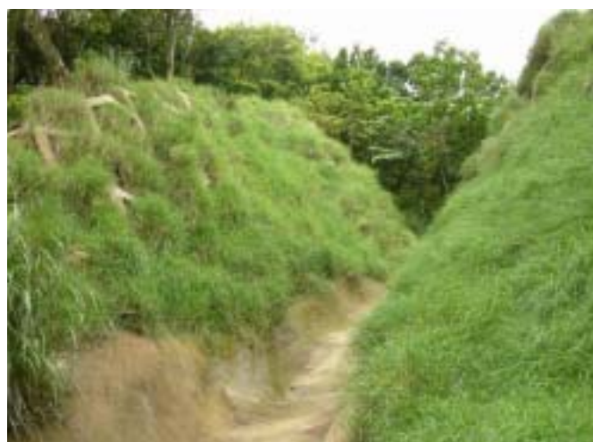
圖 2-15 崩塌地整治區最上端靠近廢礦坑處較陡峭的邊坡，左側可見裸露之型框。
