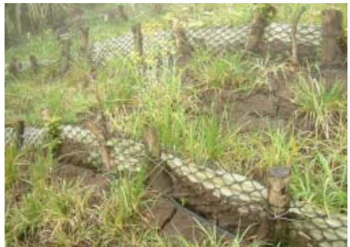
圖 5-4 竹子湖崩塌地打樁編柵結構物及表土層受植生覆蓋與受沖蝕現況。
