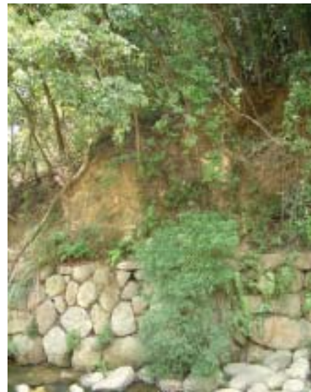
圖 5-3 大溝溪中游處護岸上方略顯不穩的邊坡
