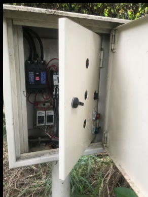
既有水井設備(二) 近教學池
