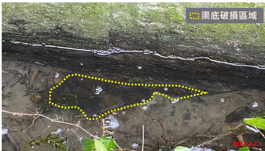
圖 11 灌溉溝渠渠底破損情況照片
