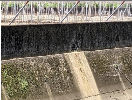
已出現破裂之護岸 (拍攝日期 110.07.05)
