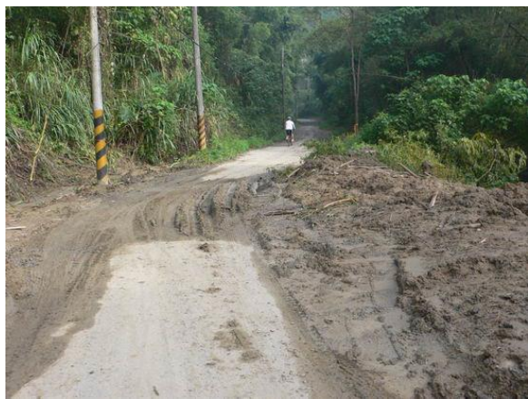
山區道路雨後坍方
