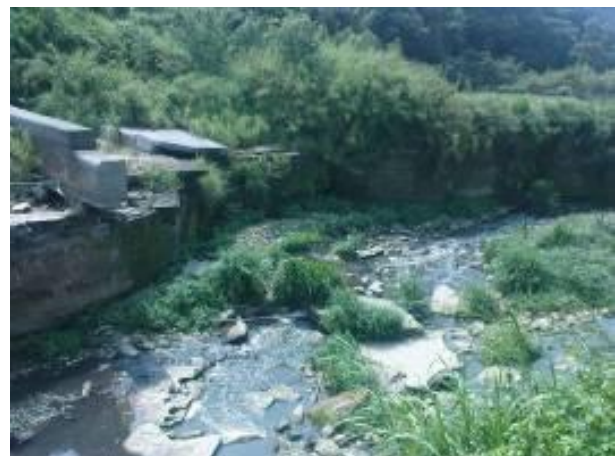
圖 2-3 固床工懸空導致斷裂(南屏橋至頂福橋之間)
