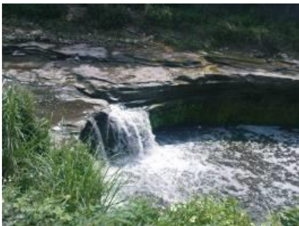
圖 2-2 林口溪河道下切現況(南屏橋至頂福橋之間)
