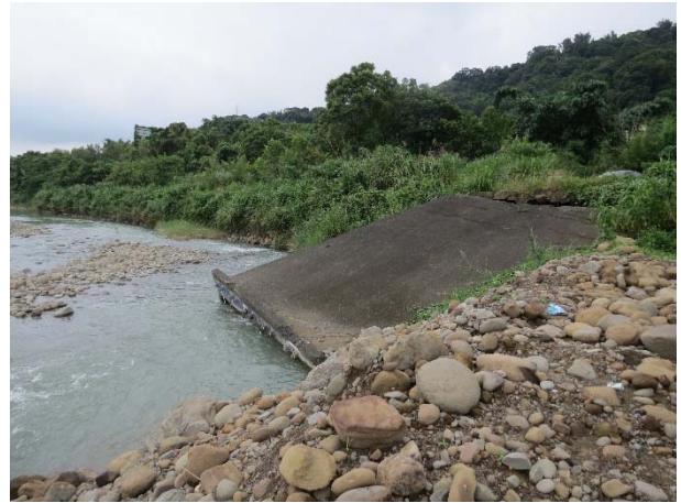
右岸水門破壞
