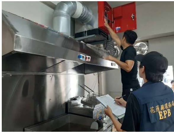
圖 3. 油煙防制設備查核
