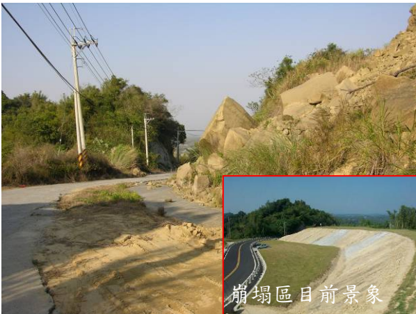
照片四~37 此露頭南段東側的崩坍，崩坍材料尚具稜角。
