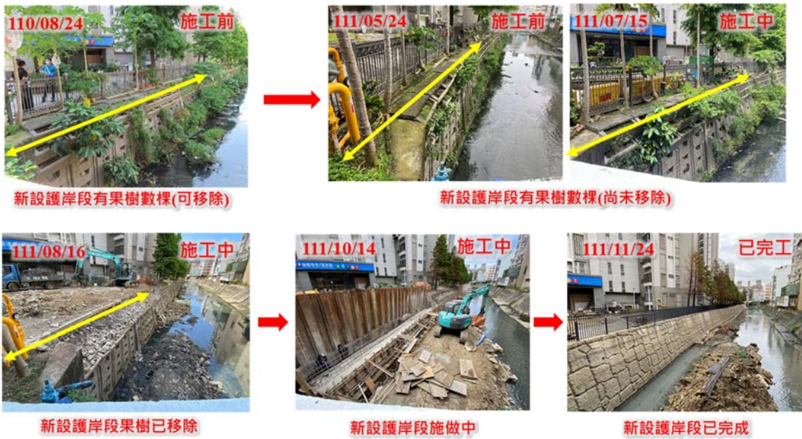
(a) 施工前、中、後新設護岸段之喬木移除與工程施做情況
