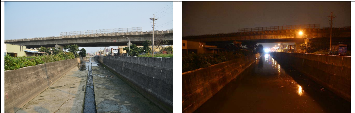
國道 3 號至龍江街 215 巷段，於 2019 年 3 月 20 大潮之滿潮時水位。
